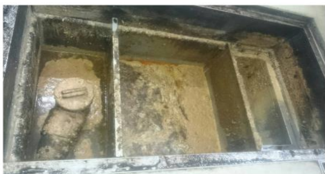
大学生協食堂の排水溝内
